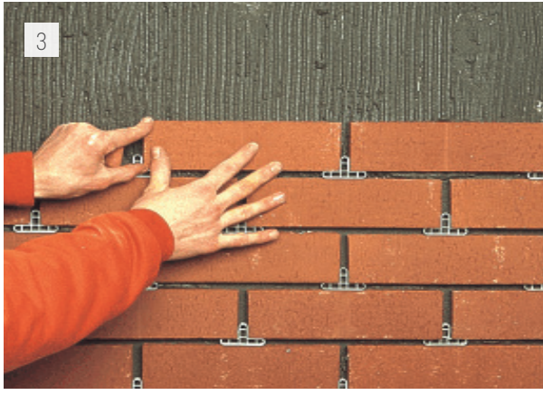
3 Kaplama tuğlaları için kullanılacak derz dolgusu min. 1 cm genişlikte uygulanabilmektedir. // Joint filler, which is to be used for brick slips can be applied min. 1 cm in width.
